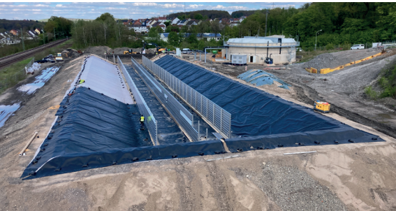
Schönungsbecken und Eindicker Camphausen Objektplanung, SiGeKo, Örtl. BÜ & Tragwerksplanung
