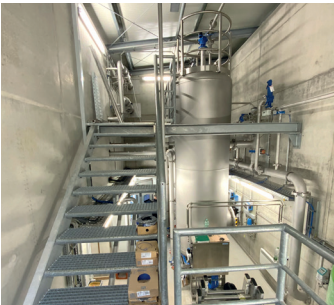
Wasserwerk Hermersbergerhof Techn. Ausrüstung & Bautechnik
